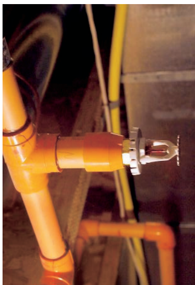
Impianto a pioggia (sprinkler)
