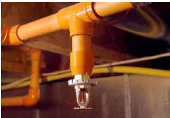
Impianto a pioggia (sprinkler)
