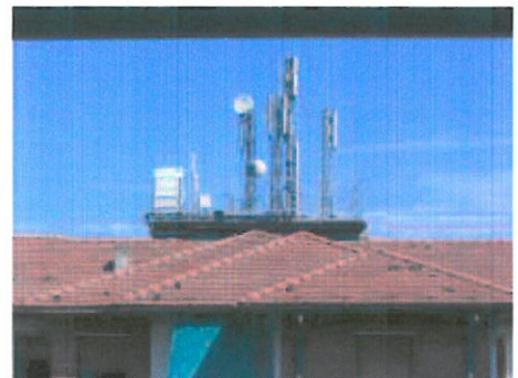
Stazioni Radio Base (SRB) e ponti radio per la telefonia cellulare installate su edificio.
